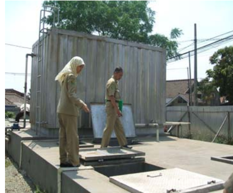
IPAL di RSUD Soreang dengan sistem biologi, yang baru beroperasi tahun 2006
