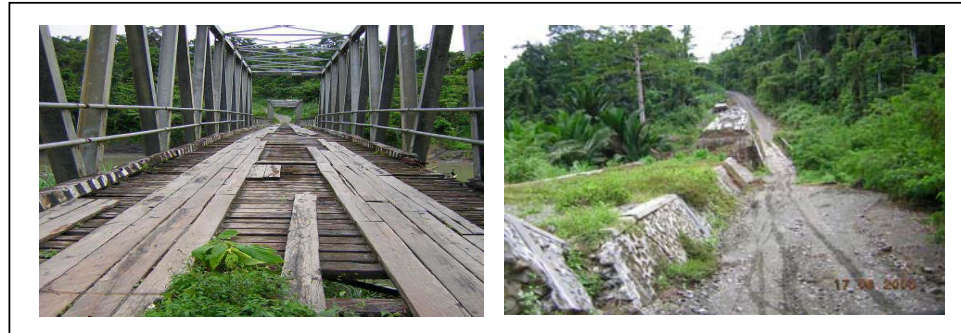
Gambar 2.10. Jalan Web yang rusak dan Jembatan di Waris yang rusak
