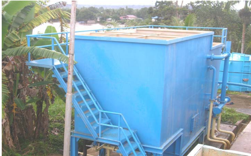
Gambar 3.6. Instalasi Pengolahan Air PDAM Kabupaten Sintang
