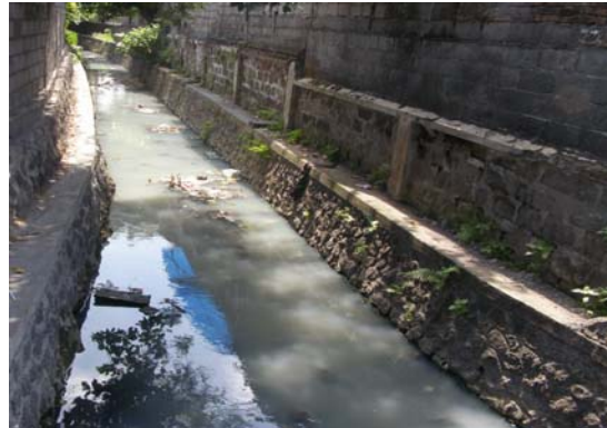
Gambar 3.2. Kondisi saluran air umumnya di Kota Denpasar
