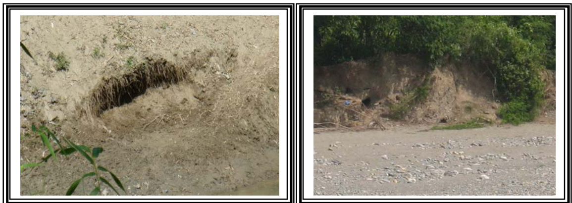
Kondisi tepi/tebing sungai di sepanjang DAS yang semakin melebar dan rapuh strukturnya
