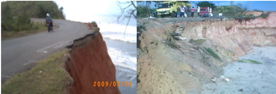
Gambar 3. Kerusakan jalan akibat abrasi
