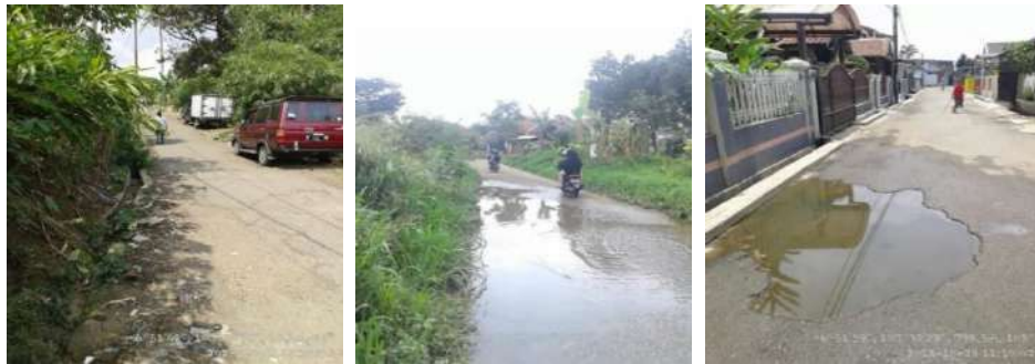
Gambar 2.66 Kondisi Saluran Drainase di Kelurahan Cipageran
