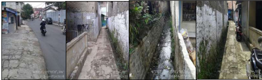
Gambar 2.68 Kondisi Saluran Drainase di Kelurahan Cibabat
