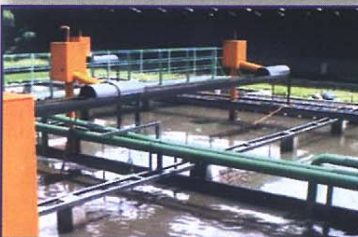
Sistem Instalasi Pengolahan Air Limbah (IPAL) pada industri Karet
